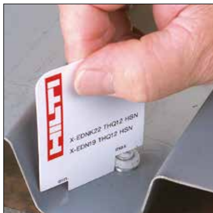
Verificando la separación de una fijación X-EDN en una cubierta de techo con una plantilla de plástico.
