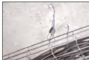
Bandejas ligeras para cables / iluminación
