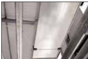
Ductos de ventilación cuadrados
